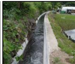
老朽化した用水路の整備・更新
